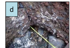
▲④洗掘(B-14 前面海底地盤)
