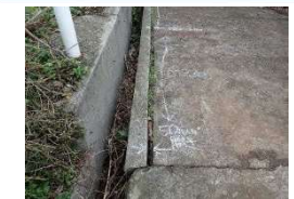
▲⑧側壁傾斜(開きW=45mm)
