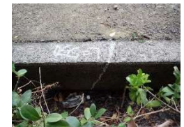
▲⑥ひび割れ
