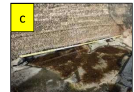
▲④洗掘(B-19 前面海底地盤)
