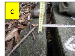
▲③目地のずれ(B-17 排水工)
