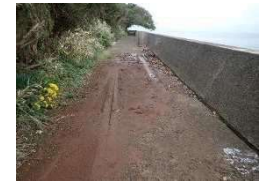
▲②土砂堆積(全体的)
