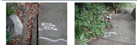
▲⑦側壁傾斜(開き W=50mm) ▲土砂堆積、植生繁茂
