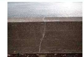
▲④ひび割れ
