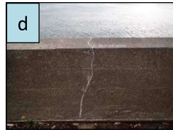
▲①ひび割れ(B-3 波返工)
