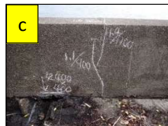
▲①ひび割れ(B-16 波返工)
