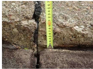
写真2 沈下量100mm(区間No.3 B-15)
