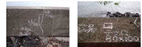
▲③ひび割れ ▲④鉄筋露出
