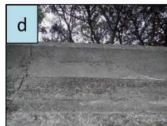
▲①ひび割れ(B-12 波返工)
