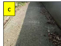
▲ひび割れ(B-17 天端被覆工)
