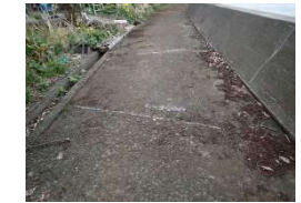
▲②ひび割れ
