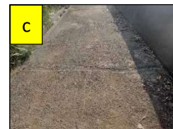
▲②ひび割れ(B-7 天端被覆工)
