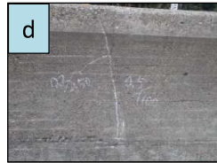
▲①ひび割れ(A-3 波返工)
