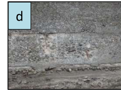
▲③鉄筋露出(A-1 表法被覆工)
