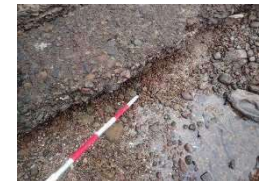
▲④その他(漏水)
