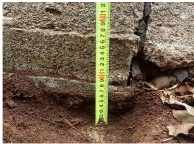
写真1 沈下量180mm(区間No.2 B-7)
