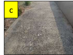
▲②ひび割れ(A-2 天端被覆工)
