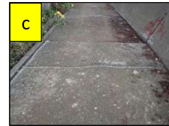
▲②ひび割れ(B-2 天端被覆工)
