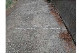
▲②ひび割れ
