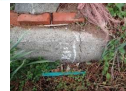
▲⑤ひび割れ
