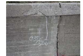
▲④ひび割れ(波返工)
