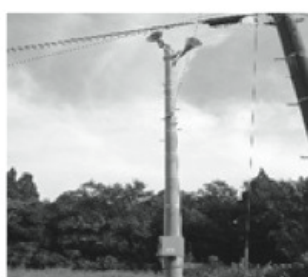
屋外放送設備②
