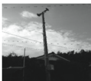
屋外放送設備②
