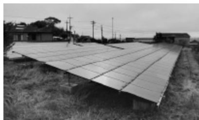
太陽光パネル
